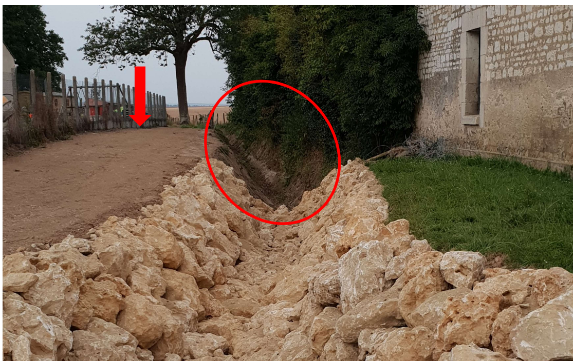
Photo 30 : fossé « exutoire » : chemin à décaisser et berge à renforcer
